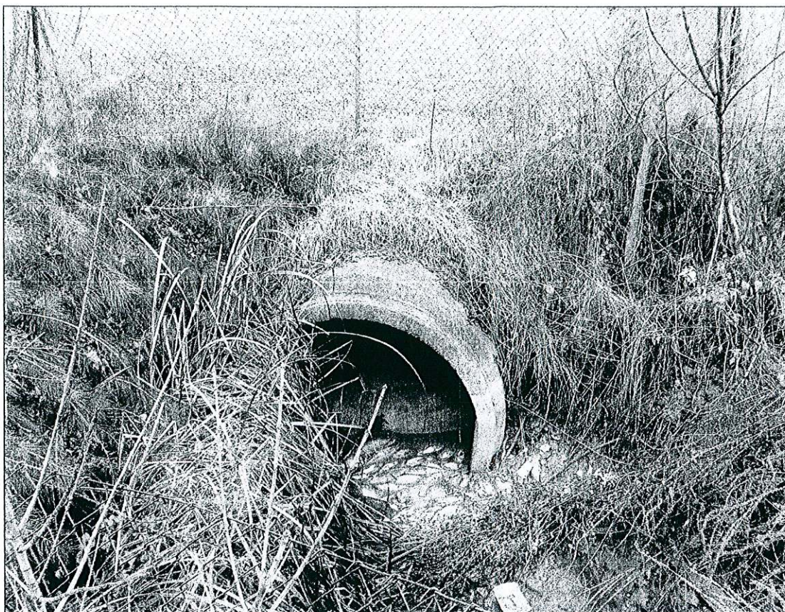
Vista Fotografica n° 6: particolare della condotta ovoidale h=1500 in cemento, che convoglia le acque miste provenienti dalle urbanizzazioni limitrofi a quella di cui in oggetto - urbanizzazione " Dalla Villa Spa " – 2° Stralcio – all'interno del medesimo fossato naturale, invaso naturale o punto di recapito che già ante-operam porta le acque nel tombinamento, ubicato sotto i binari della ferrovia, e da qui al canale Cona Acque Alte
