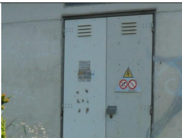
Foto 13 – vista interno lotto (particolare cabina)
