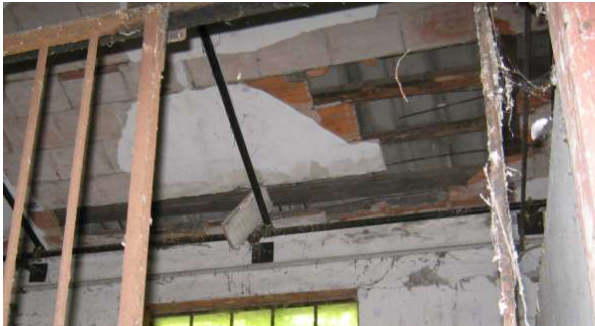
Figura 63 - Scuderia n.4: porzione di chiusura del sottotetto con tavelle parzialmente crollate
