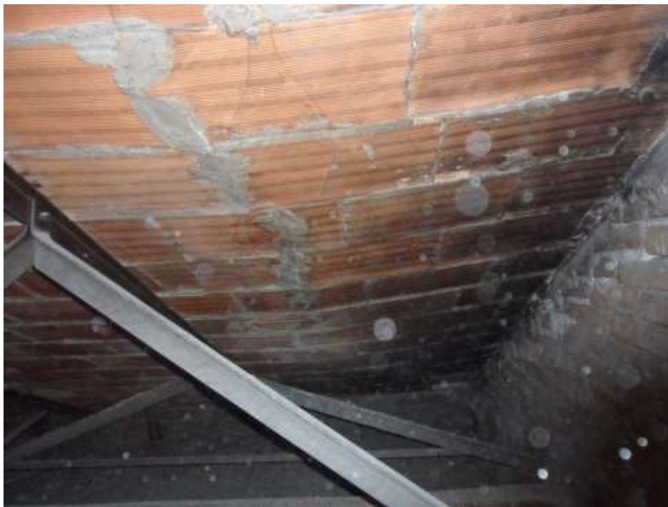
Figura 53 – Deformazione della copertura.
