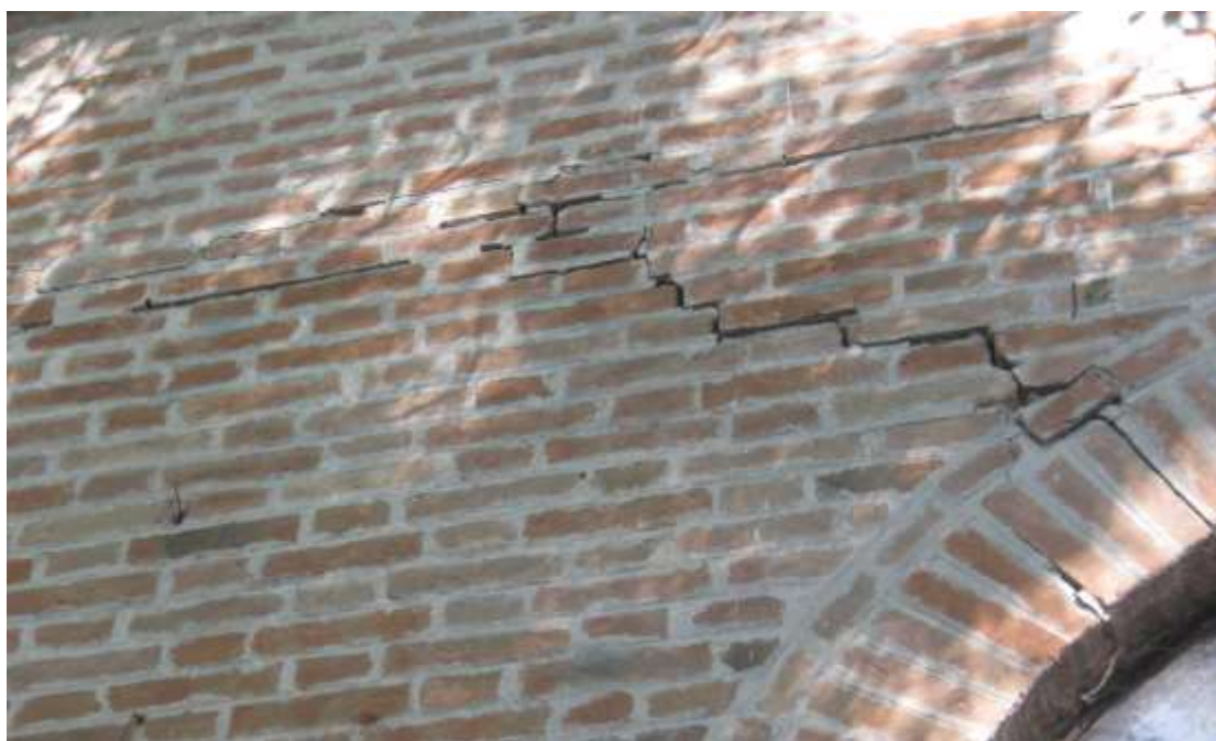
Figura 59 - Lesione estesa nella muratura del timpano della Scuderia n.4
