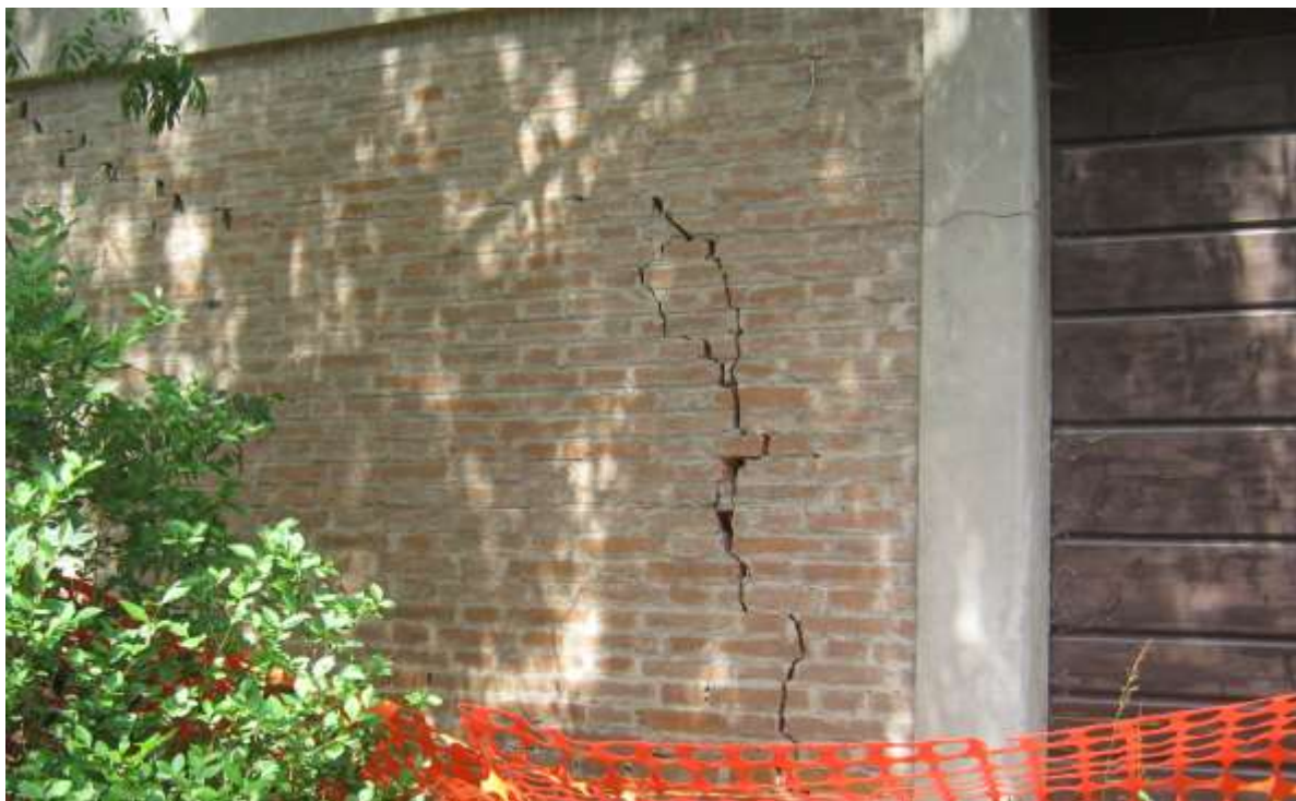
Figura 58 - Lesione estesa nella muratura perimetrale della Scuderia n.4
