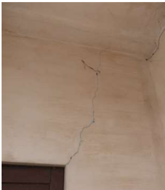
Figura 51 - Lesioni nella muratura interna
