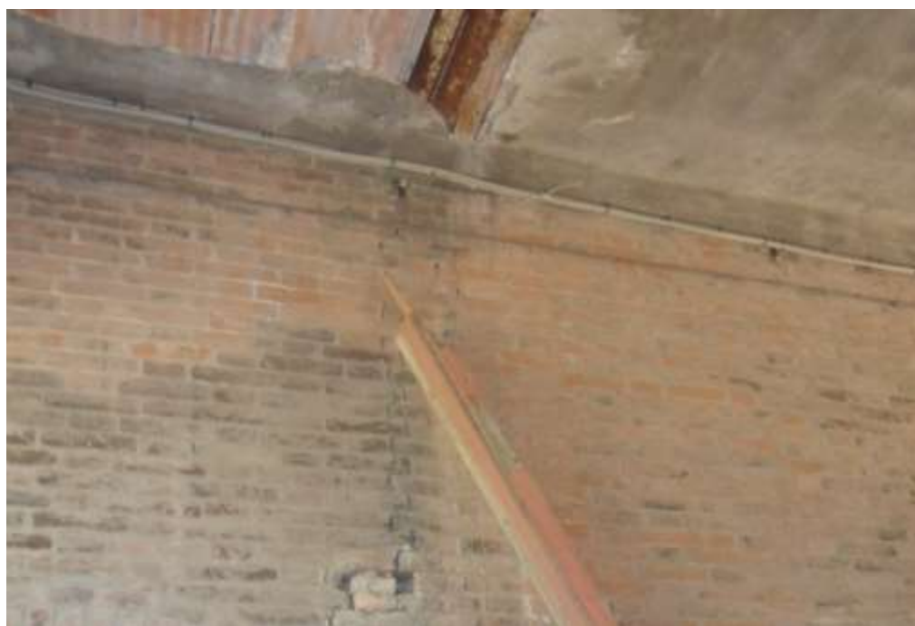
Figura 52 - Lesione dovuta alla presenza di muro in falso sull’orizzontamento soprastante
