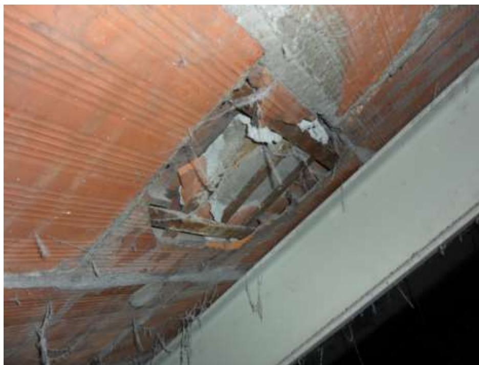
Figura 54 – Distacco di elementi in laterizio della copertura.
