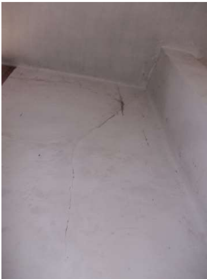
Figura 57 - Lesione della muratura adiacente al pilastro in c.a. della pensilina, in corrispondenza del piano secondo.
