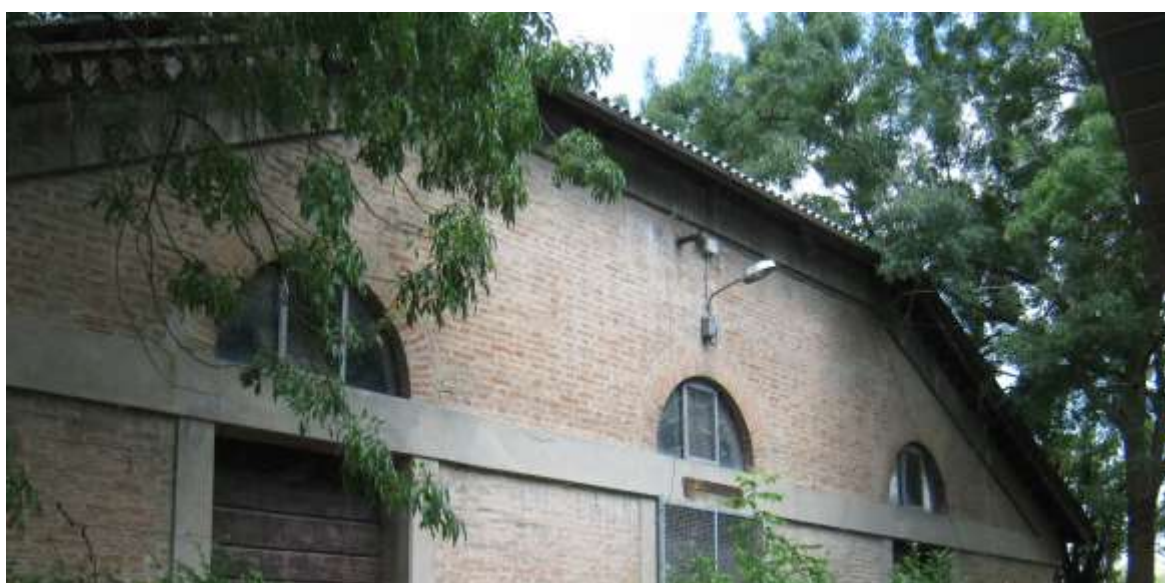
Figura 62 - Scuderia n.4: sommità del timpano priva di cordolo sommitale (l'elemento visibile appena sotto lo sporto di gronda è puramente decorativo e non ha alcuna funzione strutturale)
