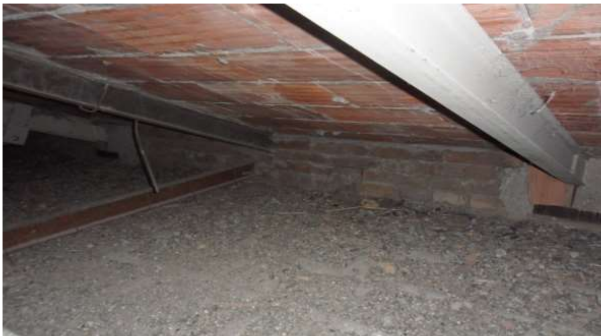
Figura 56 – Sottotetto dell'Edificio Principale. Si nota la mancanza di cordolo alla sommità della muratura in corrispondenza dell'imposta della falda di copertura.
